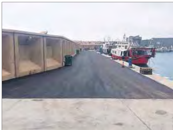
Aquesta pavimentació facilita la feina a pescadors i treballadors del port ■ PORTS
