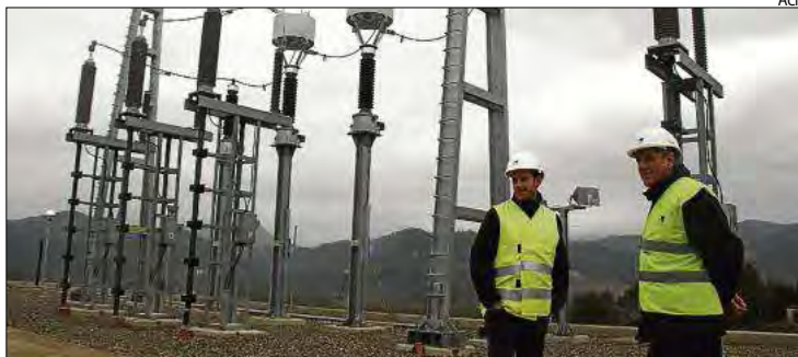
Amb la subestació de Bescanó, Endesa reparteix l'energia de la MAT.
