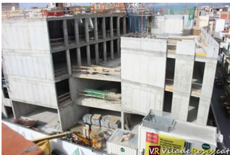
Aquest és l'aspecte que presenta la construcció de la nova sala SUF en l'actualitat
