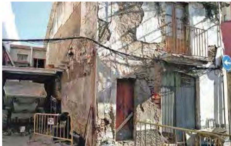
CARRER TRINITAT. L'habitatge motiu de l'enderroc estava en estat ruïnós
