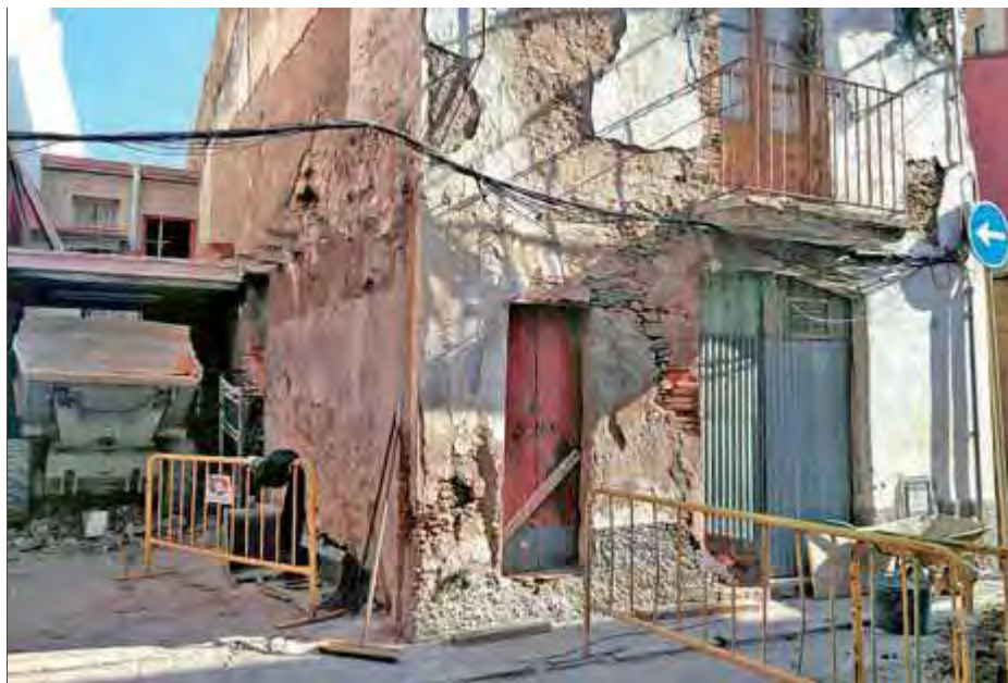
Les dues cases del carrer Trinitat estaven en un estat ruïnós ■ EPA
