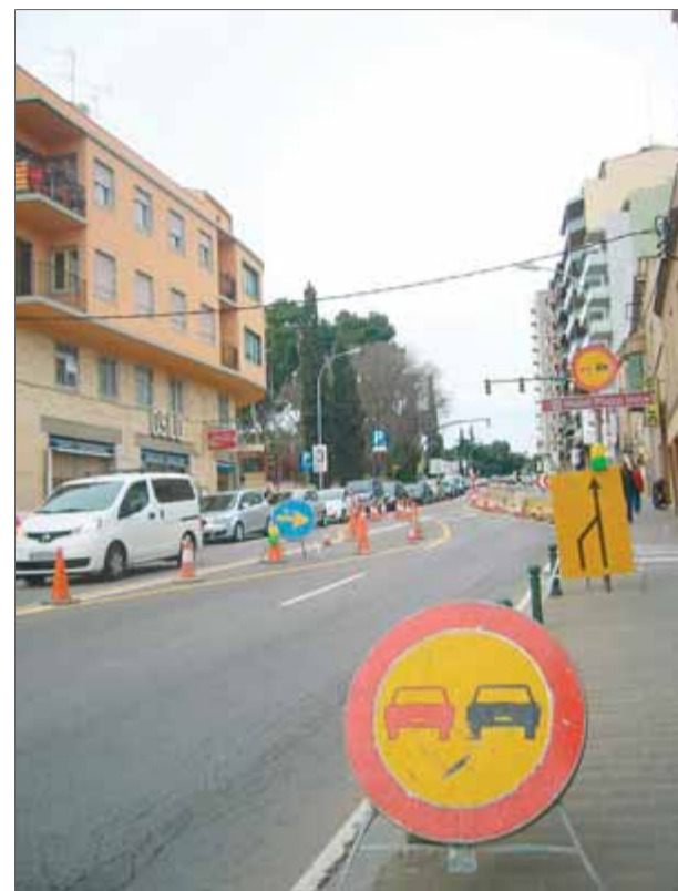
Les obres a l'avinguda Dalí afectaran el trànsit a la principal via de Figueres durant dues setmanes ■ M. VICENTE
