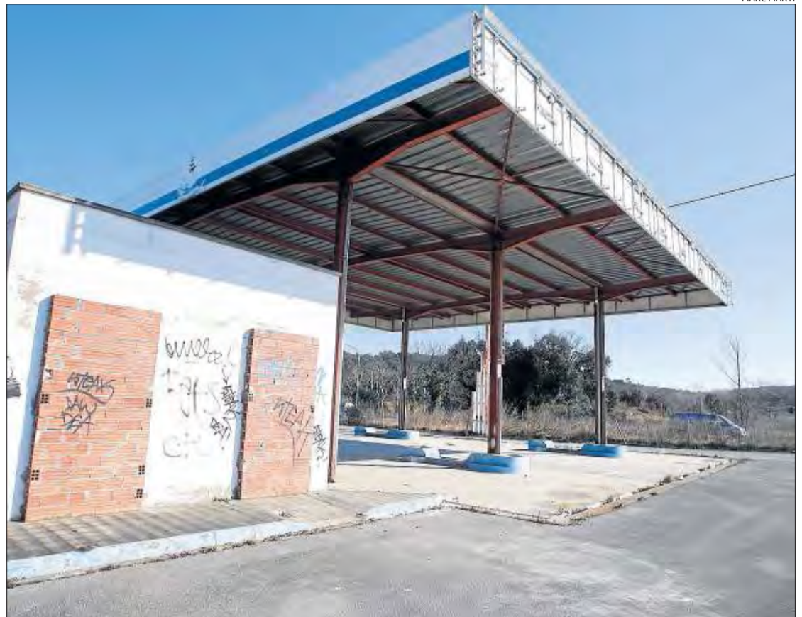
Aspecte d'una gasolinera abandonada i tancada a la carretera de Flaçà.
