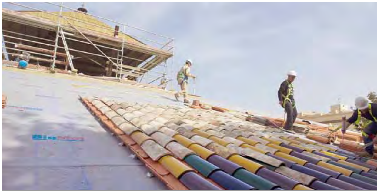
Els operaris començaven a posar ahir les teules de la coberta de la plaça del Gra ■ LLUÍS SERRAT
