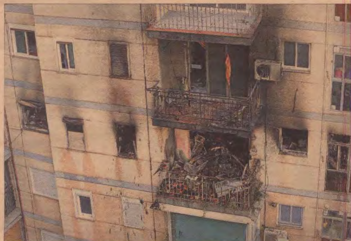
Aspecte exterior de l'edifici sinistrat a la carretera de Mataró de Sant Adrià de Besòs
