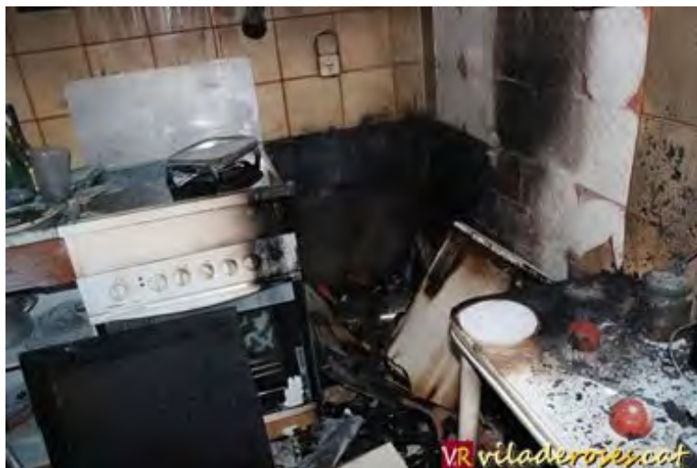
Part de la cuina que ha quedat més malmesa
