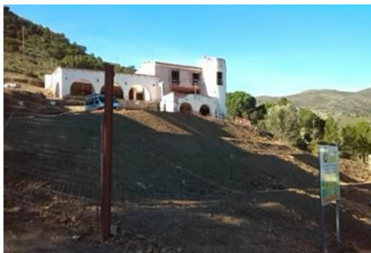
Obres a la casa particular, tala de tot l'arbrat i neteja de vegetació i moviments de terres visibles a la finca. (Foto: IAEDEN-Salvem l'Empordà)
