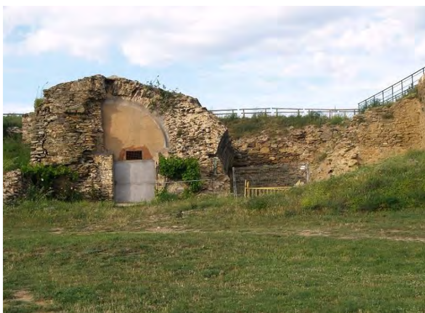
Casamatas de la Ciutadella de Roses antes de su intervención. Imagen: Joan Falgueras
