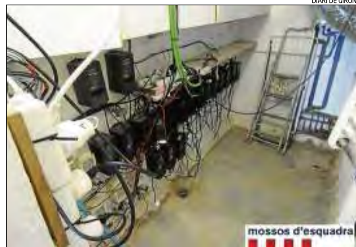
L'estat del cablejat elèctric localitzat en un dels domicilis registrats.
