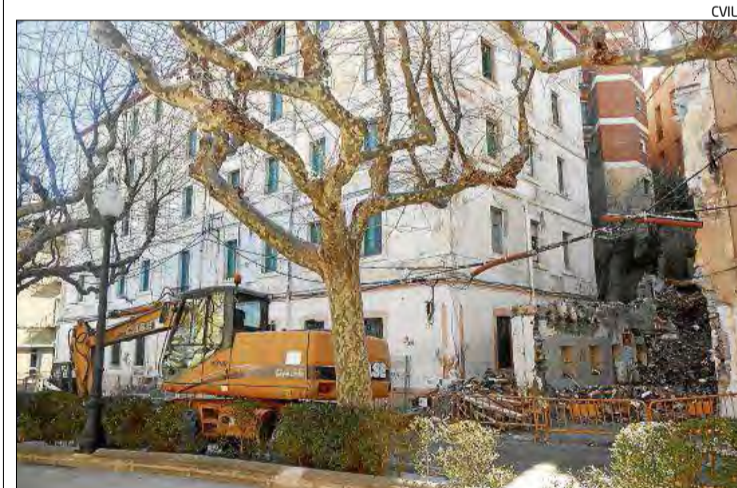
Les màquines amb l'edifici enderrocat al fons, i la caserna a l'esquerra.
