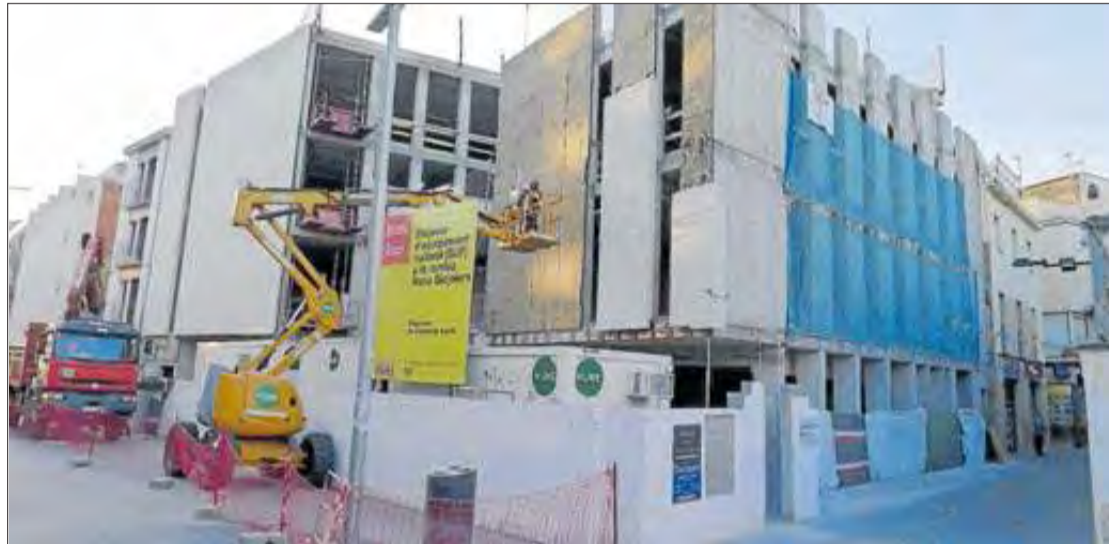
L'edifici amb l'estructura acabada, a Roses, amb un projecte arquitectònic singular. JAUME PURCALLAS
