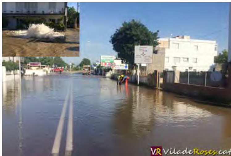
L'Avinguda de Rhode de Roses inundada. A la imatge el punt exacte on reventat la canonada
