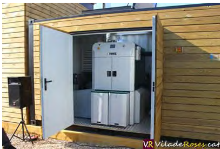
La caldera de biomassa de la Residència Pi i Sunyer de Roses / Foto: Arxiu
