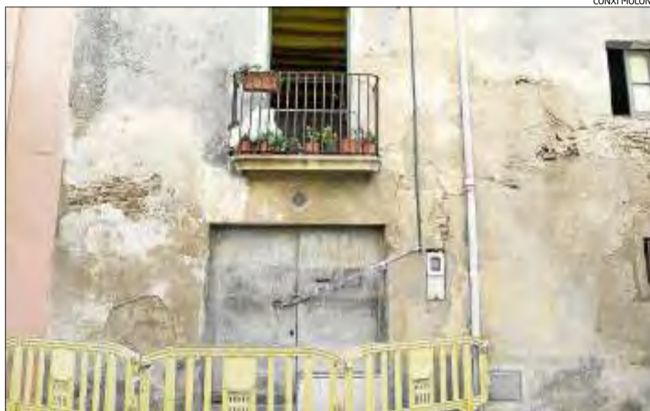
L'habitatge al carrer Pau Casals, 1, ahir a la tarda precintat després de l'esfondrament.
