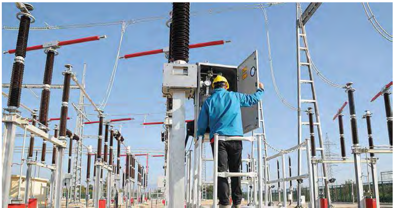
LA SUBESTACIÓ DE SANTA LLOGAIA. Finalitzada l'obra civil, la instal·lació es posarà en tensió durant la primera setmana d'octubre
