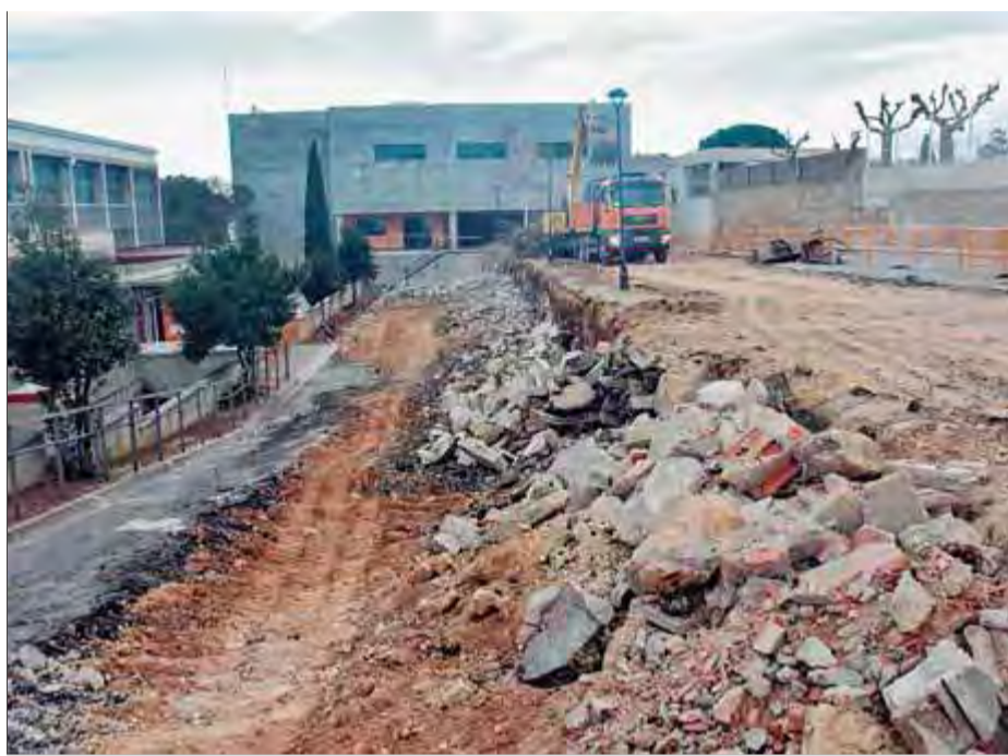
Les obres a la sala polivalent han de convertir l'aparcament en una rambla arbrada ■ ARXIU
