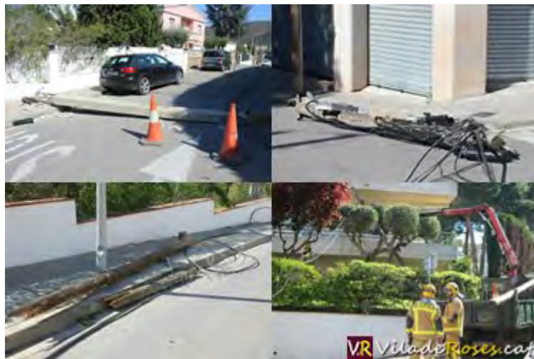
Alguns dels 6 postes de fusta i 1 de formigó que va tirar a terra el camió, i els treballs per treure el que hi havia dins una finca particular
