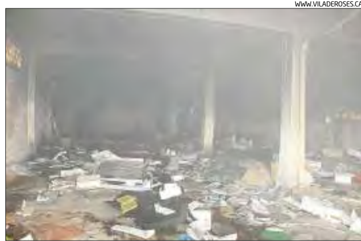
Les restes afectades pel foc a l'interior de les instal·lacions.
