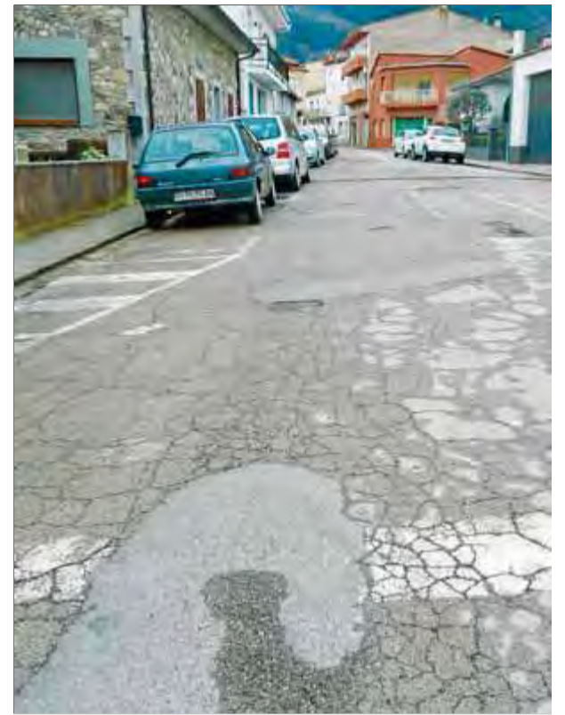
Una vista del carrer del Pla de les Planes, on el deteriorament del paviment és més que palpable ■ J.C.
