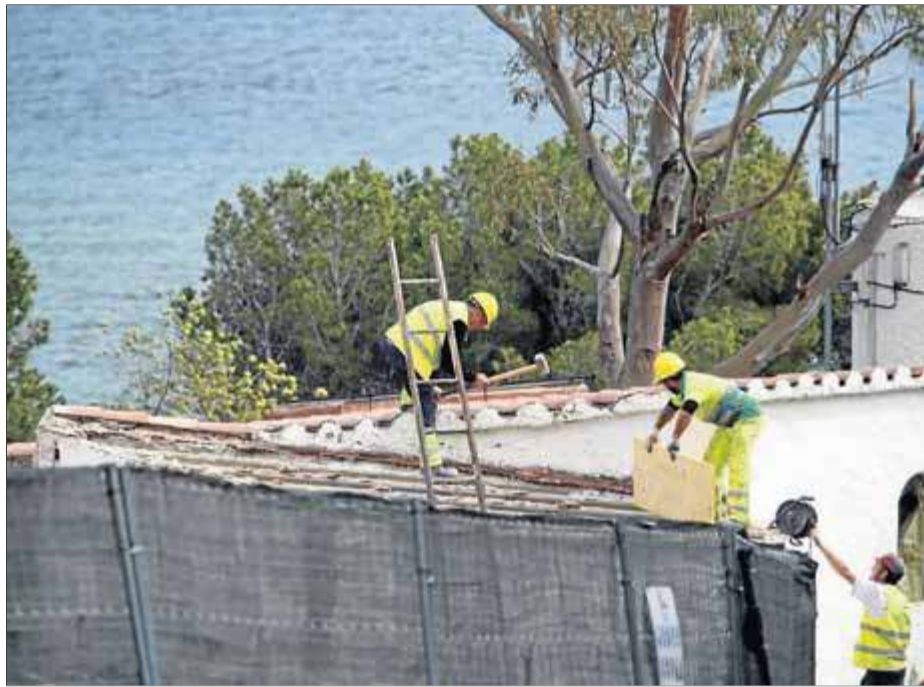
Les obres que s'estan fent a El Bulli, a la cala Montjoi de Roses ■ MANEL LLADÓ
