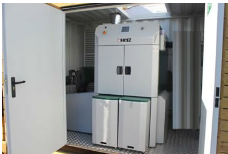
Detall de la Caldera de Biomassa de la Residència Pi i Sunyer de Roses
