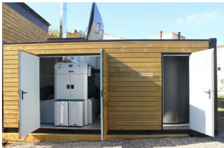
La Caldera de Biomassa instal·lada per l'empresa Reformes i Construccions José M a Fernández a la Residència Pi i Sunyer de Roses
