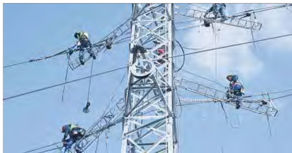
Una de les mesures ha estat la reforma del cablatge de la línia d'alta tensió ■ ENDESA
