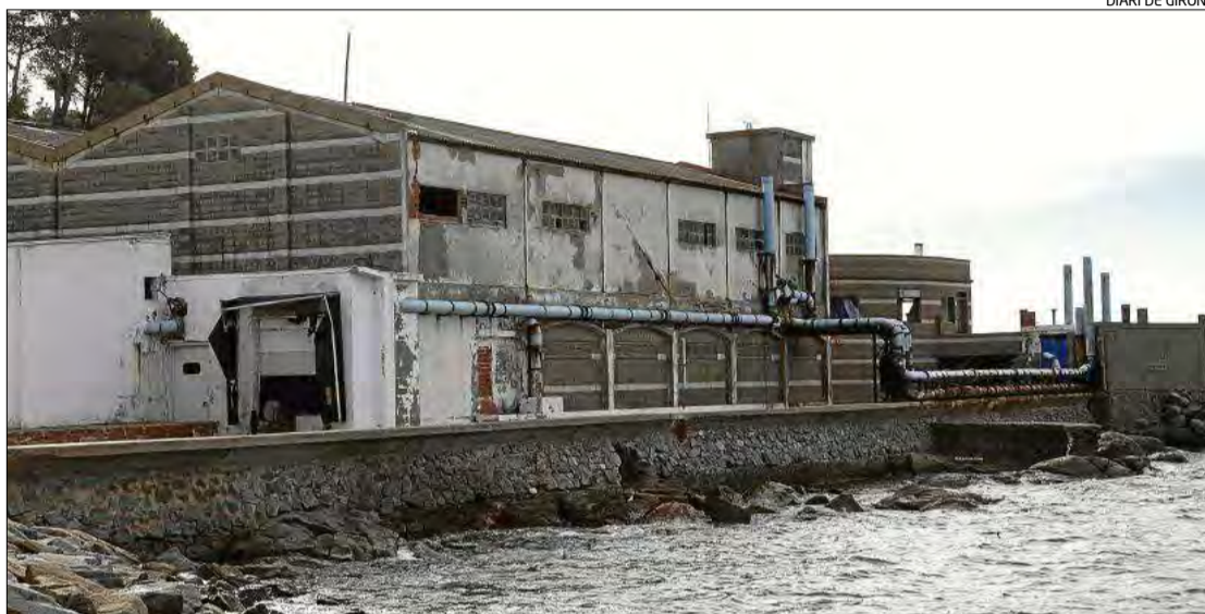
Les instal·lacions de la depuradora de marisc en desús i a l'espera que s'enderroquin.
