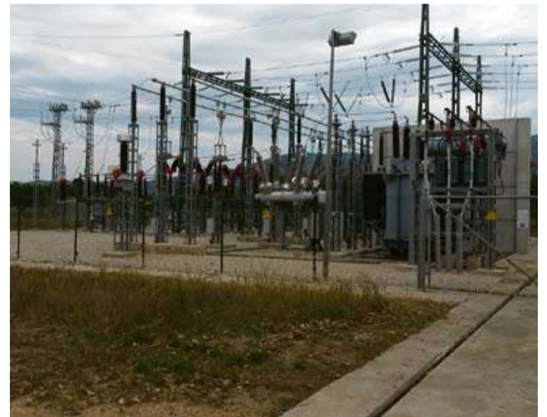
TORREVENT. Les instal·lacions estan ubicades a Palau-saverdera
