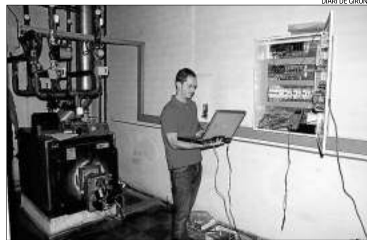
Imatge del nou sistema de calefacció que reduirà el consum un 20%.
