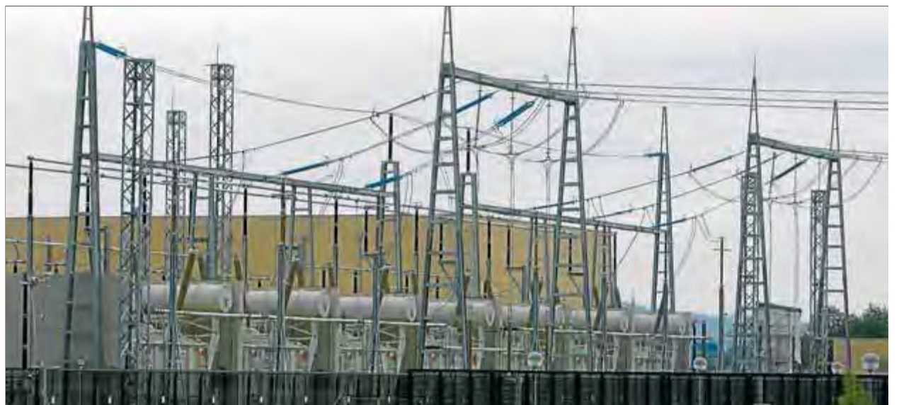
Part de les instal·lacions de la MAT que estan situades a prop del nucli de Santa Llogaia d'Àlguema ■ LLUÍS SERRAT
