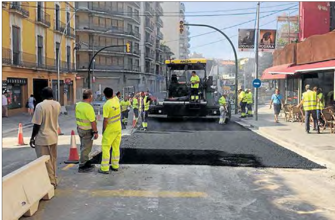
Les màquines treballant en l'asfaltatge dels vials a la plaça del Sol. C.VILÀ
