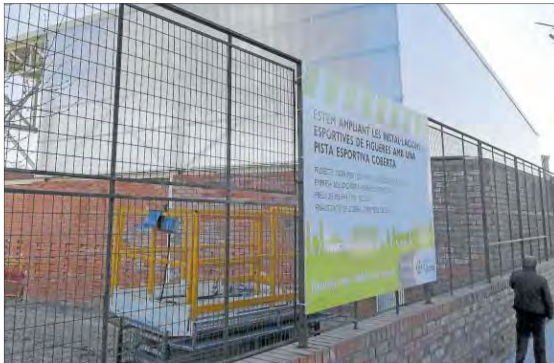
El cartell informatiu que data la finalització de les obres al mes de desembre. DdG/ARXIU
