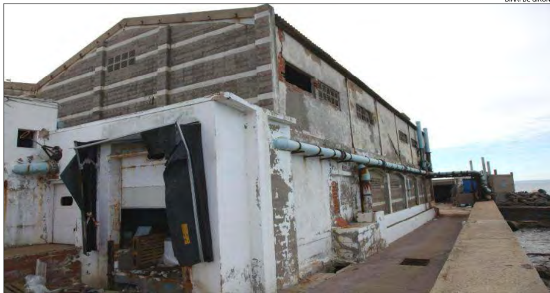
Les instal·lacions actuals de la depuradora de marisc que estan molt degradades.
