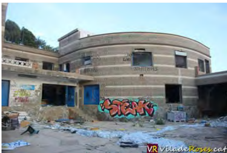
Estat actual de les instal·lacions de l'antiga depuradora de marisc de Roses
