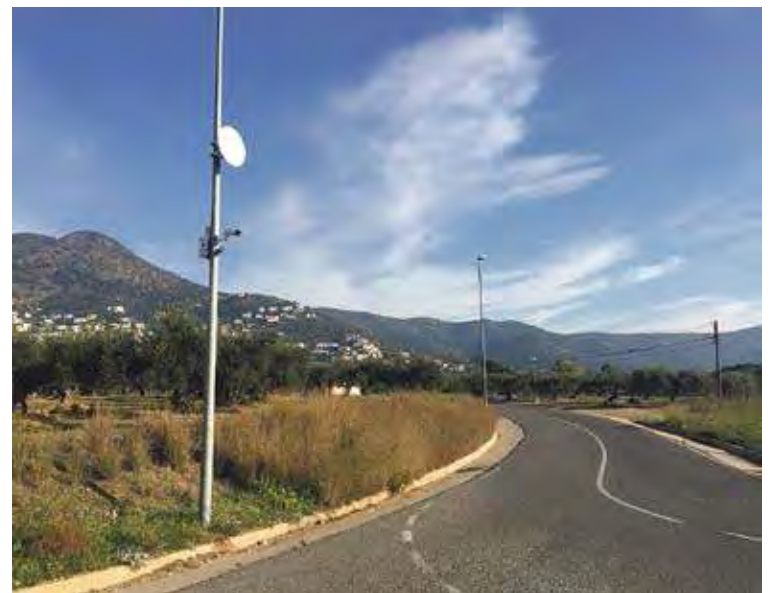
AL MAS FUMATS. Camera de vigilància als accessos de la urbanització AJ ROSES
