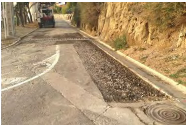
Carrer de la urbanització en mal estat on s'han iniciat els treballs pel seu arranjament
