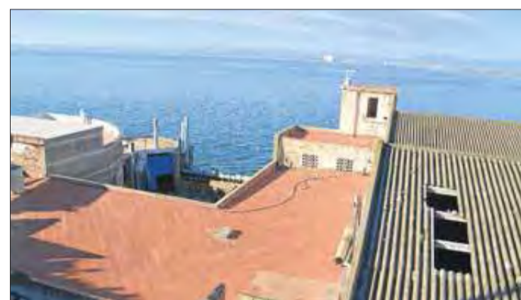
La degradació de l'antiga depuradora de marisc va en augment. SANTI COLL
