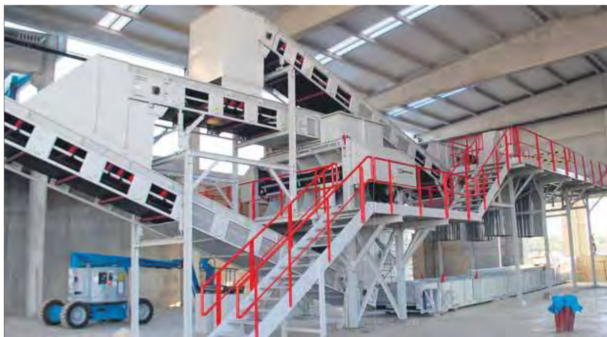
La nova maquinària del Centre de tractament de residus ja està gairebé instal·lada ■ EPA
