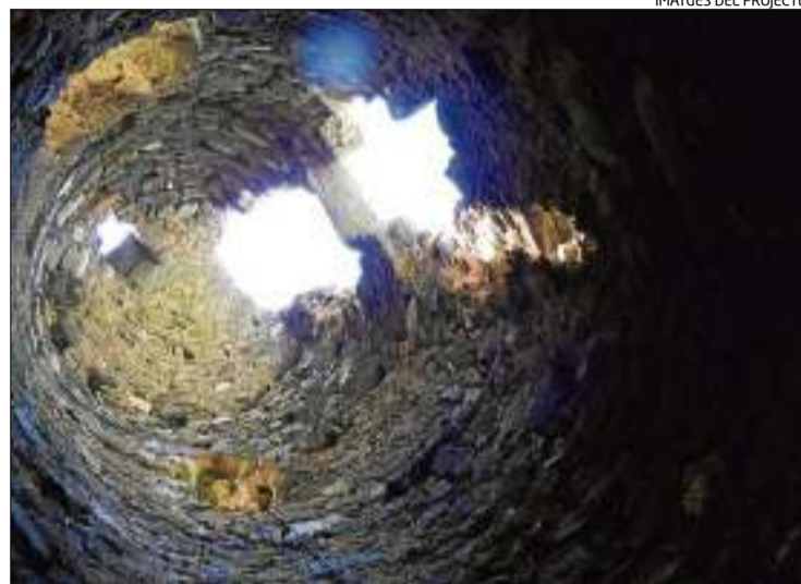
Una imatge des de l'interior que permet veure el mal estat.
