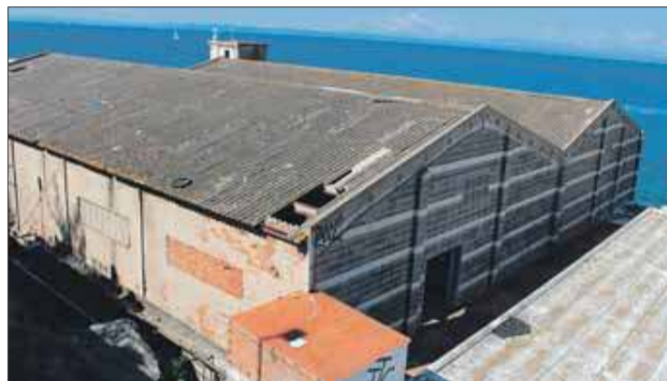
L'edifici, a primera línia de mar, es troba en estat ruïnós. EMPORDÀ
