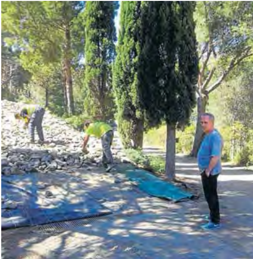
El cuiner Ferran Adrià supervisant les obres per a la construcció d'una part d'El Bulli Foundation, a Roses, al cap de Creus. CLOUD 9
