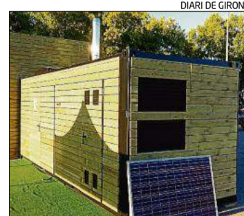
La instal·lació de Roses.
