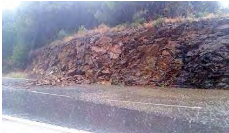
GI-612. Hi va haver una esllavissada entre el Port de la Selva i Llançà ROGER PINART
