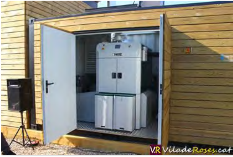
La caldera de biomassa de la Residència Pi i Sunyer de Roses
