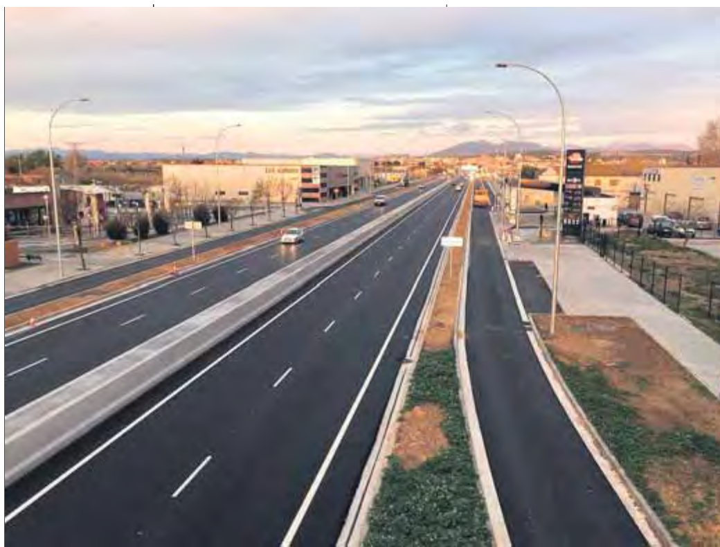
Els quatre carrils centrals de la C-260 al pas per Vilatenim ja estan oberts al trànsit
