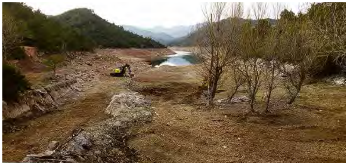
ACTUACIONS. Garanteixen el correcte funcionament dels òrgans de desguàs i s'eviten obstruccions en avingudes d'aigua ACA
