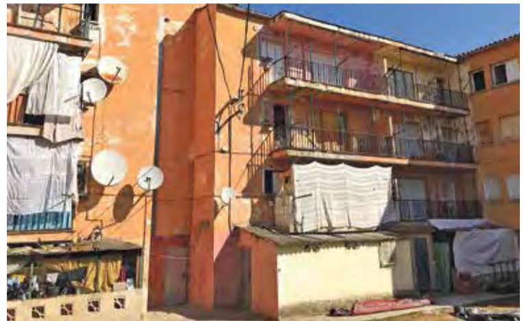
HABITATGES. Blocs de pisos necessiten urgentment millores.
