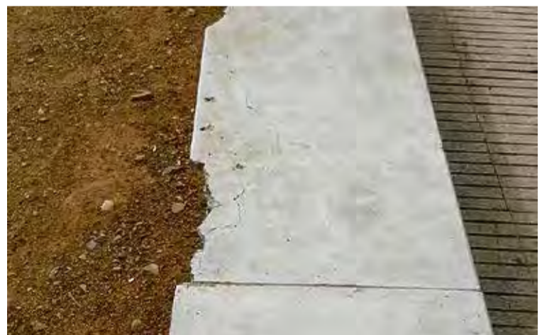
BANCADA. Pedra en mal estat que pot comportar risc per la seguretat d'infants ERC
