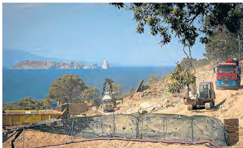
Treballs de construcció a la zona de Sa Riera el juny passat. DAVID BORRAT
