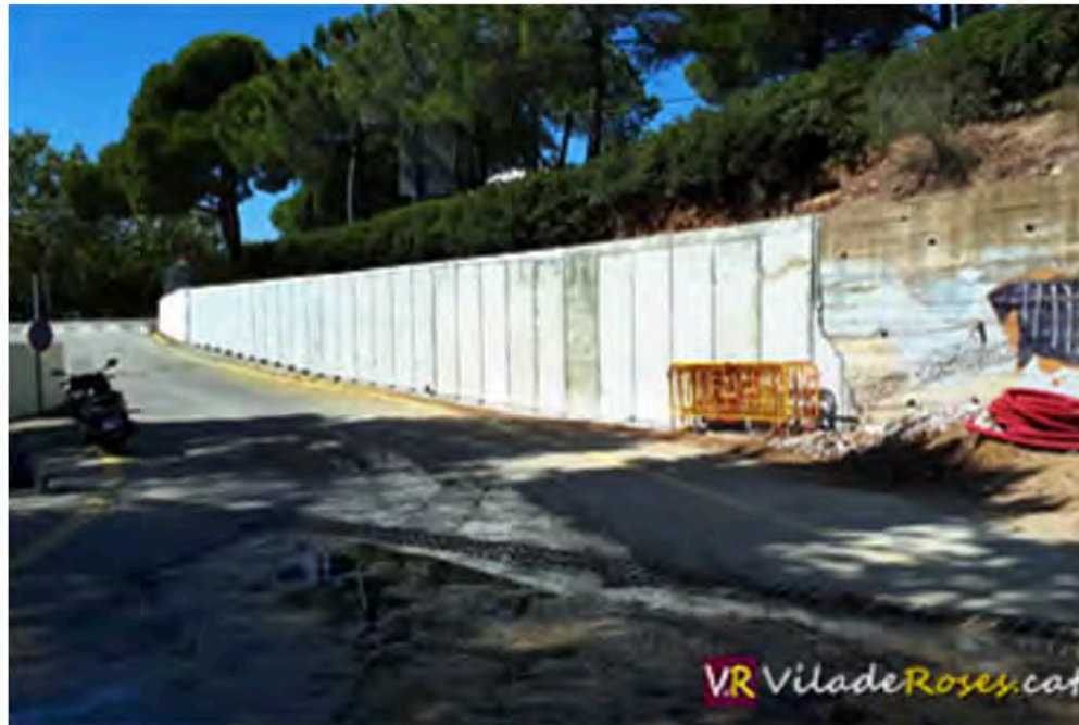
El nou mur de contenció fet a la Riera Ginjolers, a l'entorn del Centre Escolar Empordà
