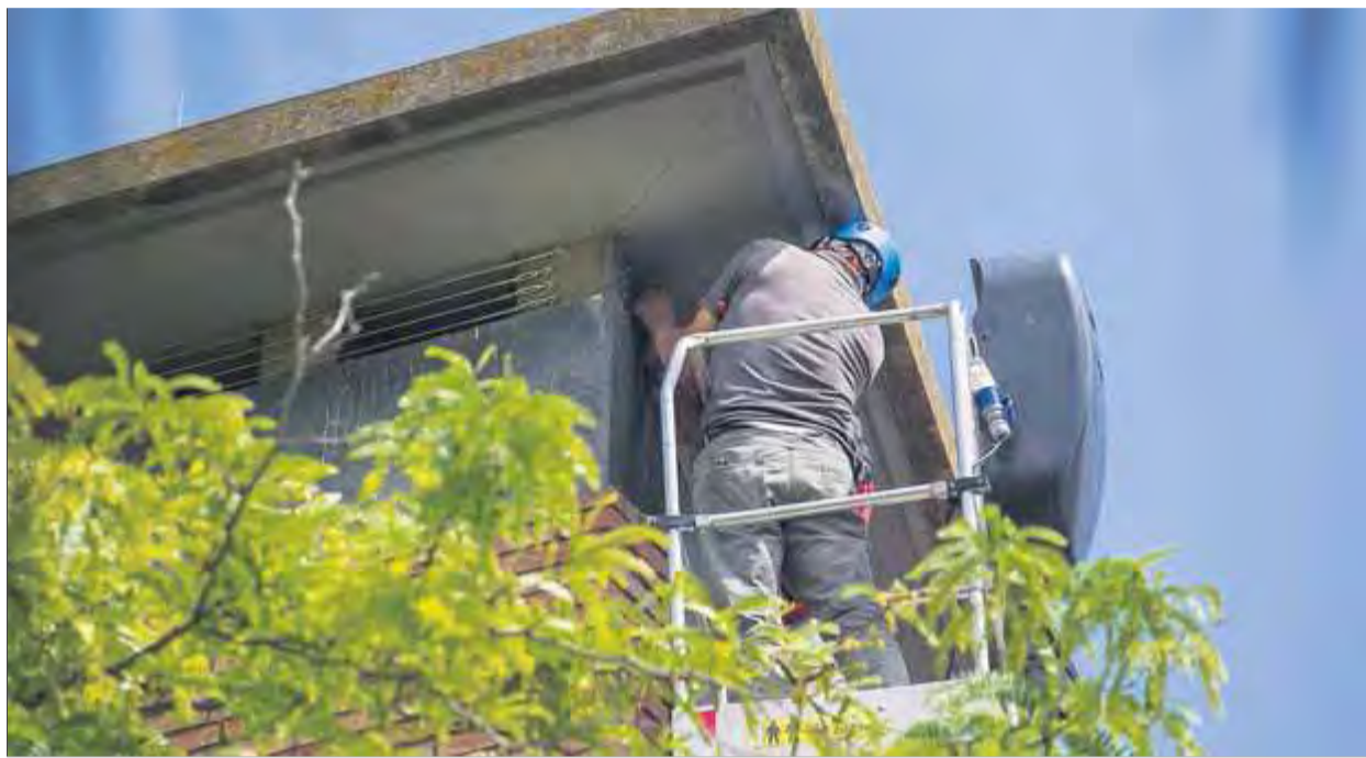
Un operari tapiava un punt per on entraven els coloms en un dels edificis municipals ■ AJUNTAMENT DE FIGUERES
