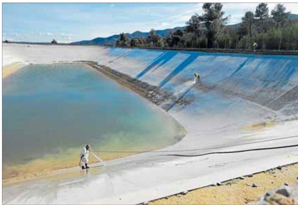
La intervenció també ha inclòs la reparació i neteja de l'embassament municipal. FOTO: AV.P.
